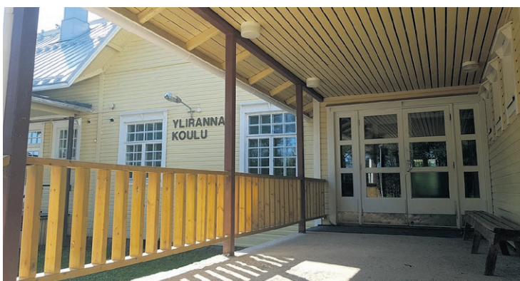
Ylirannan ja Aseman koulujen tilojen korjaustarpeita tullessa selvityksessä arvioimaan kokonaisuutena.
